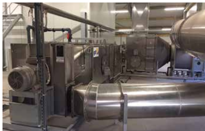
De ventilatoren bij Biogas De Biezen
