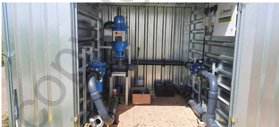
Een mobiele installatie met filters, kranen en sturing voorziet de druppelirrigatie van water.
