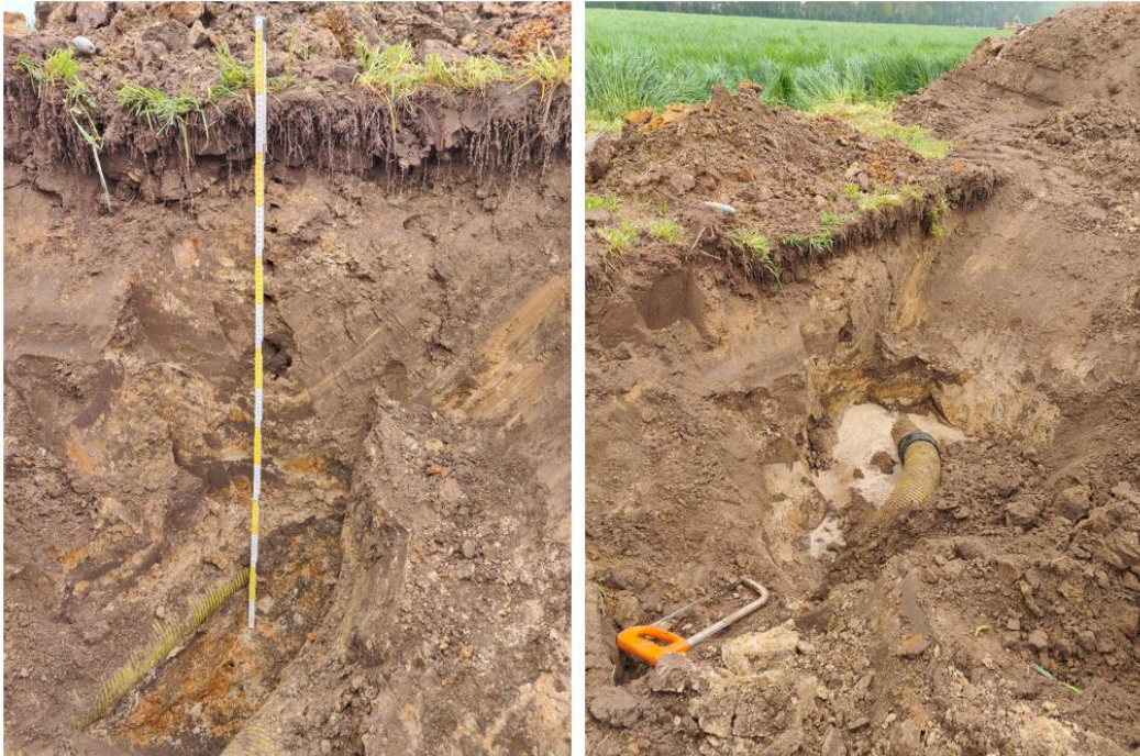
Figuur 12: Aankoppeling inlaatpunt blok C
